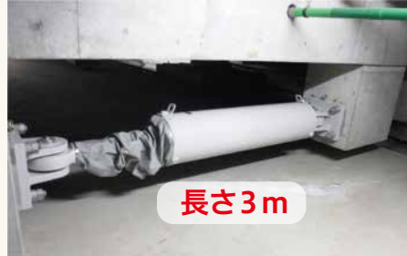
当院に設置されているオイルダンパー
